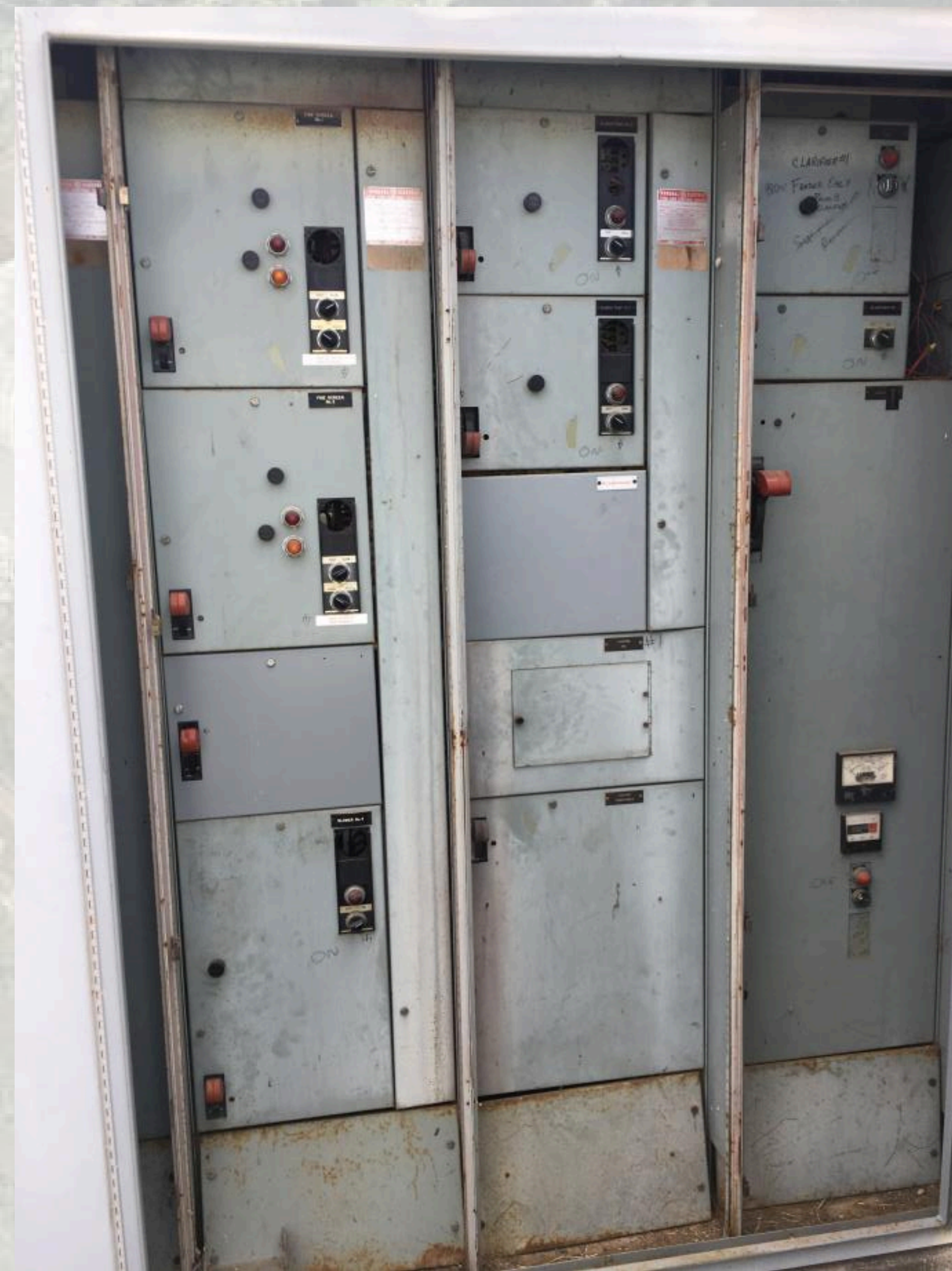
現存的 MCC（腐蝕、過時且不安全）
