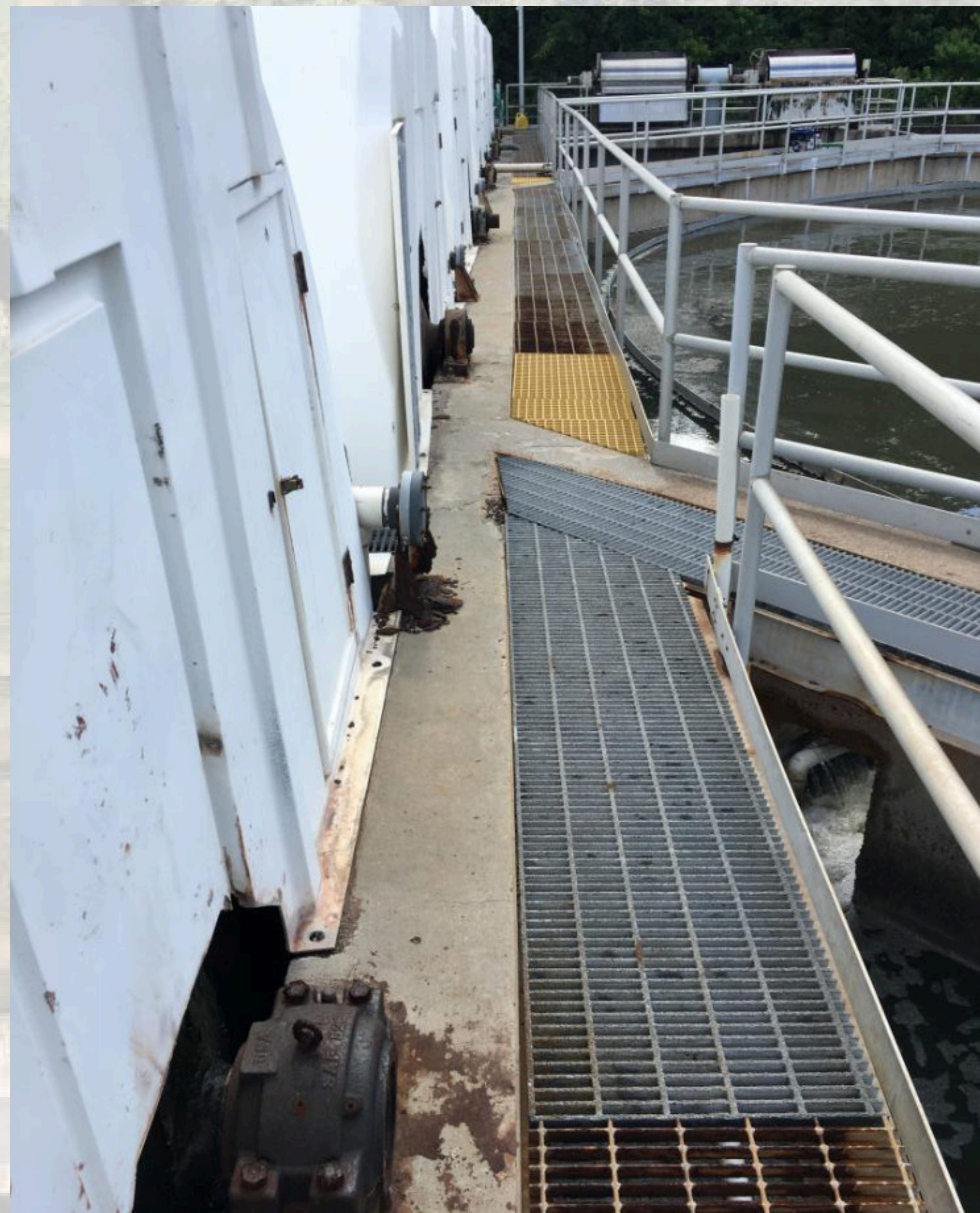
現存的 RBC（軸承和軸腐蝕）
