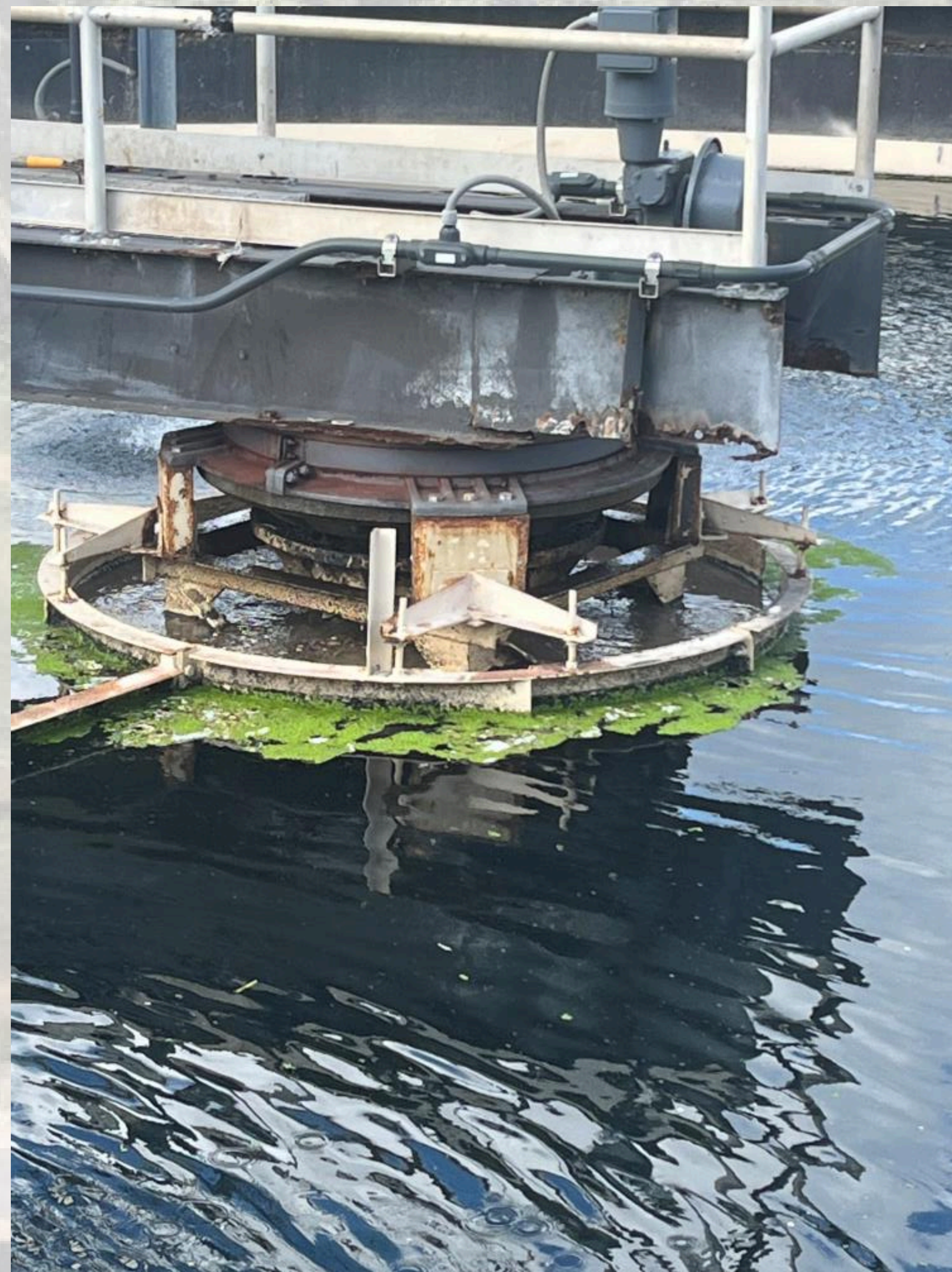
現存的沉澱池（橋和機構腐蝕）
