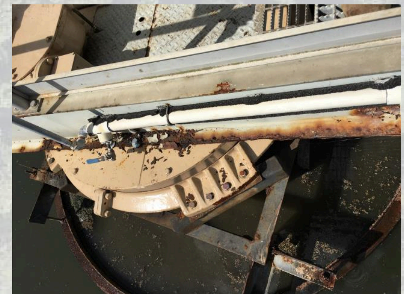
Hệ thống làm sạch hiện tại (Cầu bị ăn mòn & Cơ chế)
