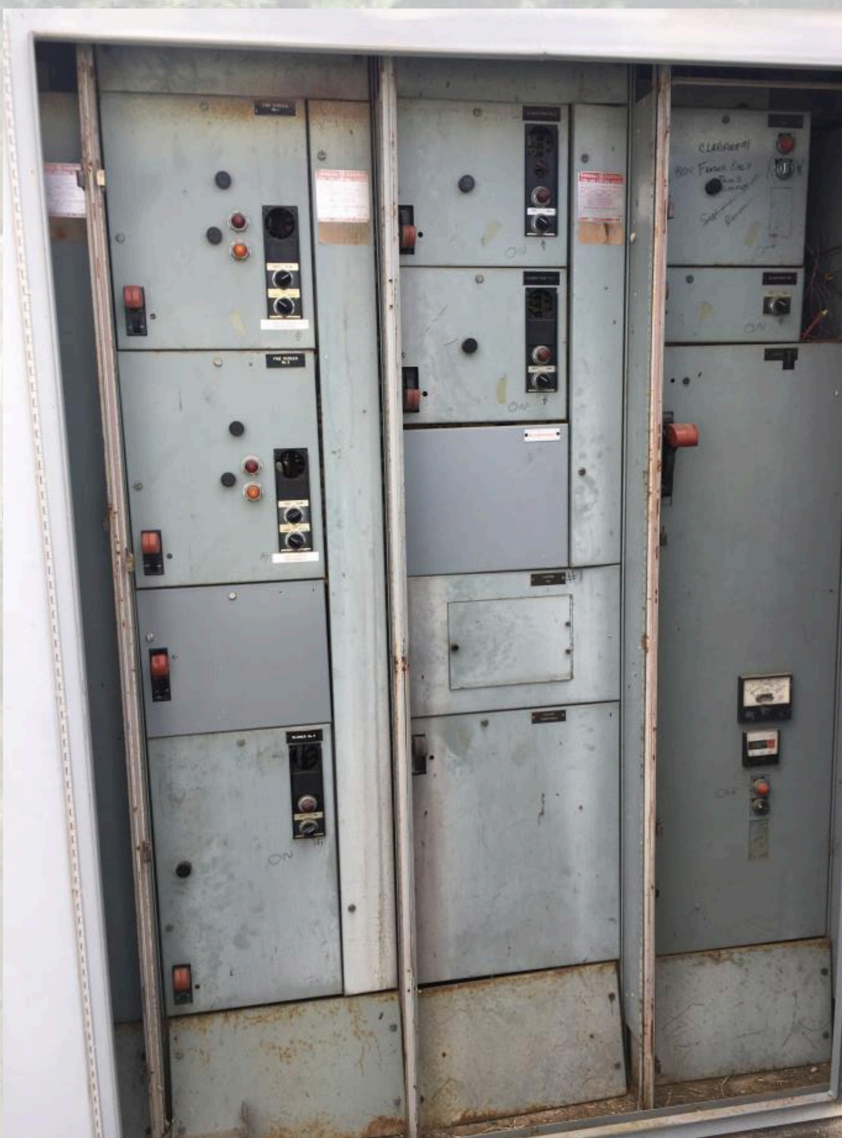
MCC hiện tại (bị ăn mòn, lỗi thời và không an toàn)
